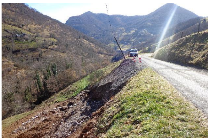
Le glissement de terrain survenu en contrebas de la RD 137, à Alos. Photo CD09
