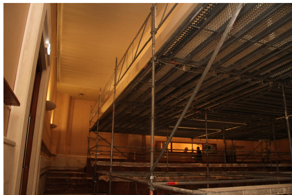
Un impressionnant échafaudage a pris place dans la salle plénière de l'Hôtel du Département.
