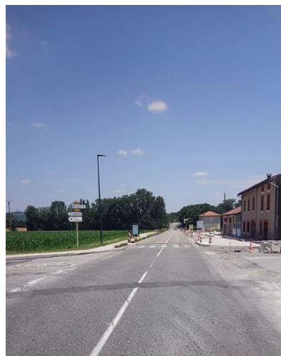
La traverse de la commune des Pujols en cours d'aménagement sur la RD 119. Photo CD09
