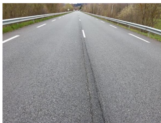
Chaussée déformée de la RD117.
