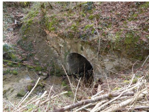
La tête amont du pont sur la ruisseau de la Baure à Nalzen va être démolie et reconstruite. Photo CD09
