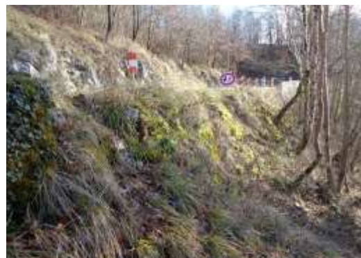
Les murs de soutènement de la RD 10 à Ilhat, avant les travaux. Photo CD09
